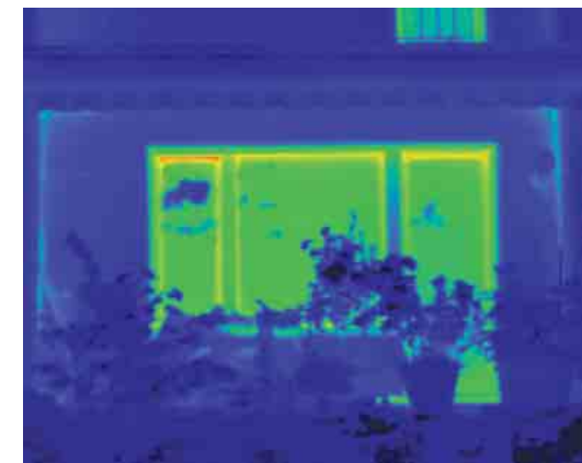
Denne termografien av nye korrekt innbygde Schüco Alu Inside-energispårevinduer illustrerer at dette er en god investering. Det opprinnelige energitapet er nesten fullstendig eliminert.
